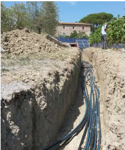
VOLTERRA (PI) 40kW
